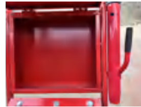
Hộp đựng vòi chữa cháy
